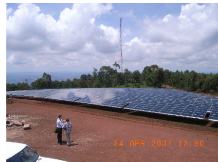
キガリのソーラー発電所（アフリカ最大）。 Solar power plant in Kigali (the biggest system in Africa).
